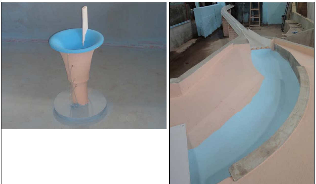
Фигура 3. Общ вид на преливната фуния и безнапорния тунел заедно с долния участък след трамплина..
